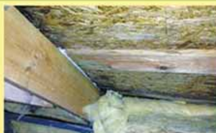
На OSB и утеплителе темные пятна плесени
