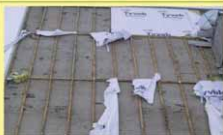
Фото разрушения теплоизоляции при отсутствии надёжной ветрозащиты Изоплат
