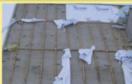
Фото разрушения теплоизоляции при отсутствии надёжной ветрозащиты Изоплат
