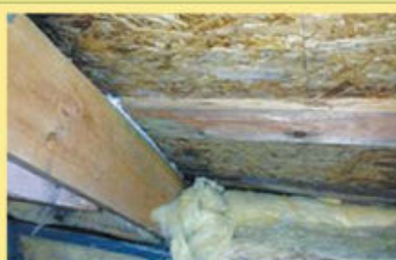
На OSB и утеплителе темные пятна плесени
